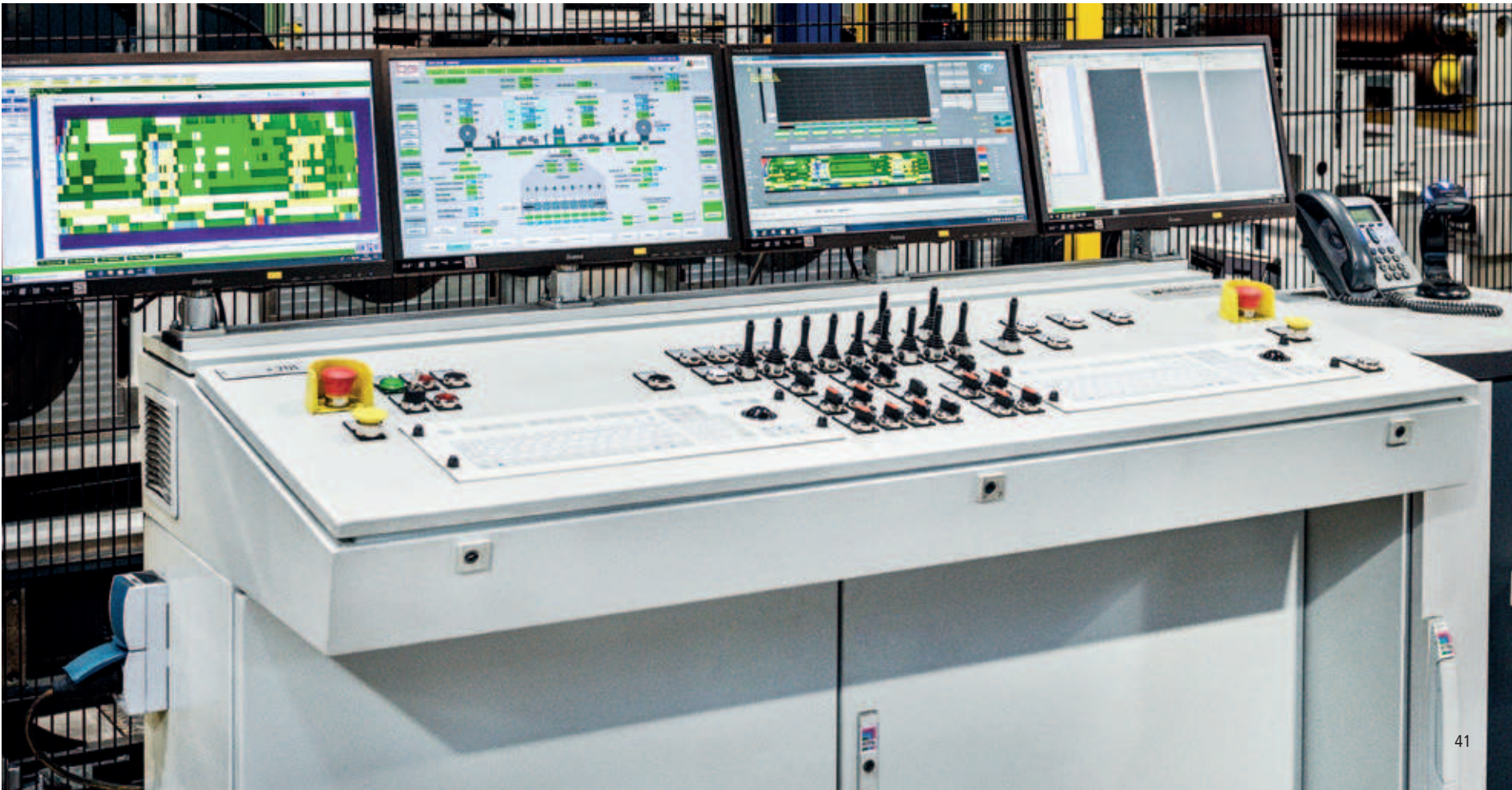
Hauptsteuerpult Main control desk
