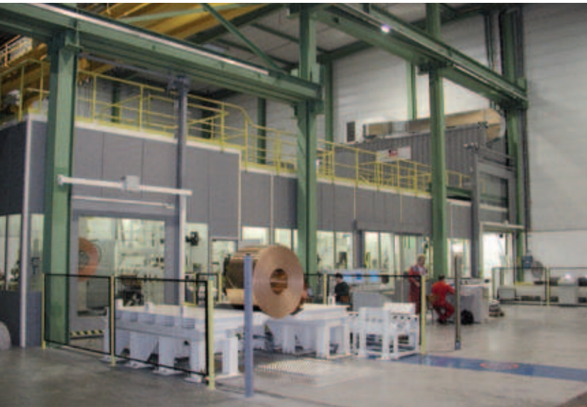
Streck-Biege-Richtanlage mit Schutzeinhausung und Schaltanlagencontainer Stretch-Bend-Leveling Line with Clean Room and MCC Container
