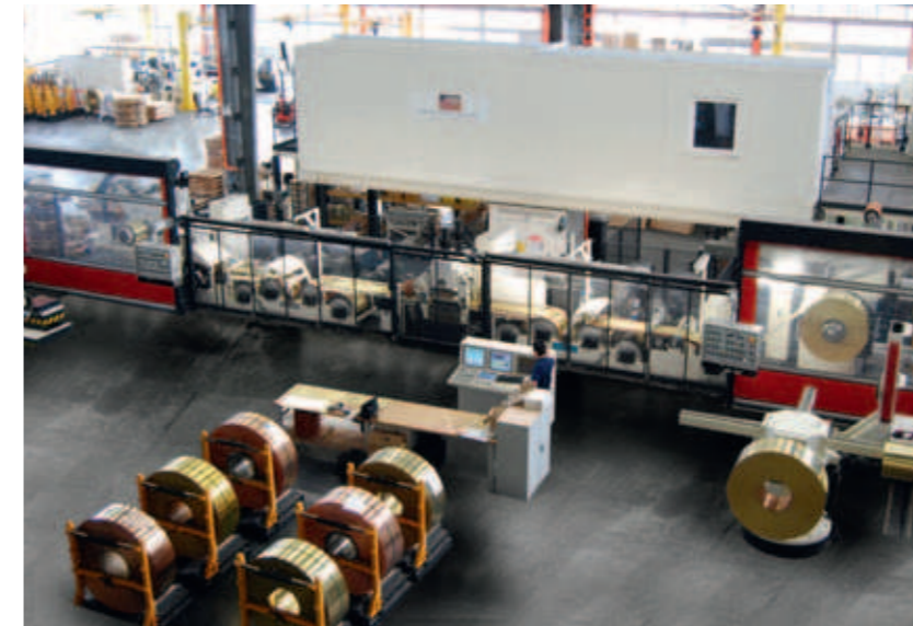
Streck-Biege-Richtanlage mit aufgeständertem Schaltanlagencontainer und Schutzeinrichtungen Stretch-Bend-Leveling Line with Overhead MCC Container and Safety Room
